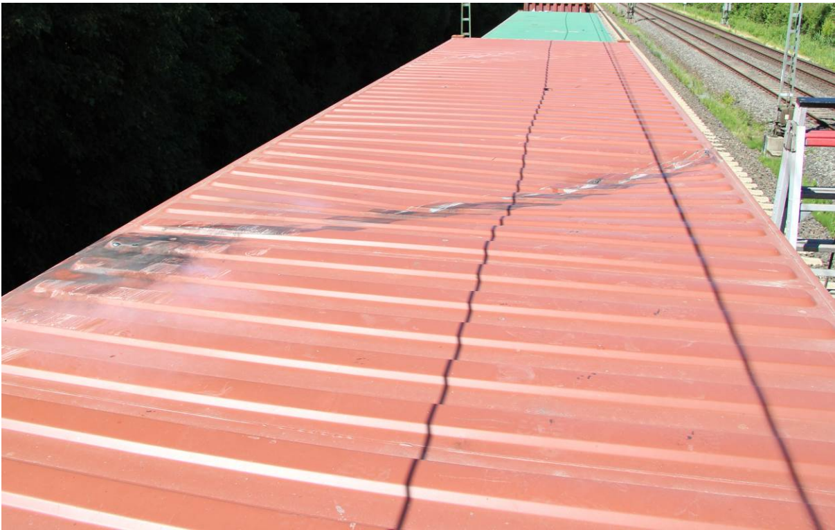
Beschädigter Container des Güterzuges
