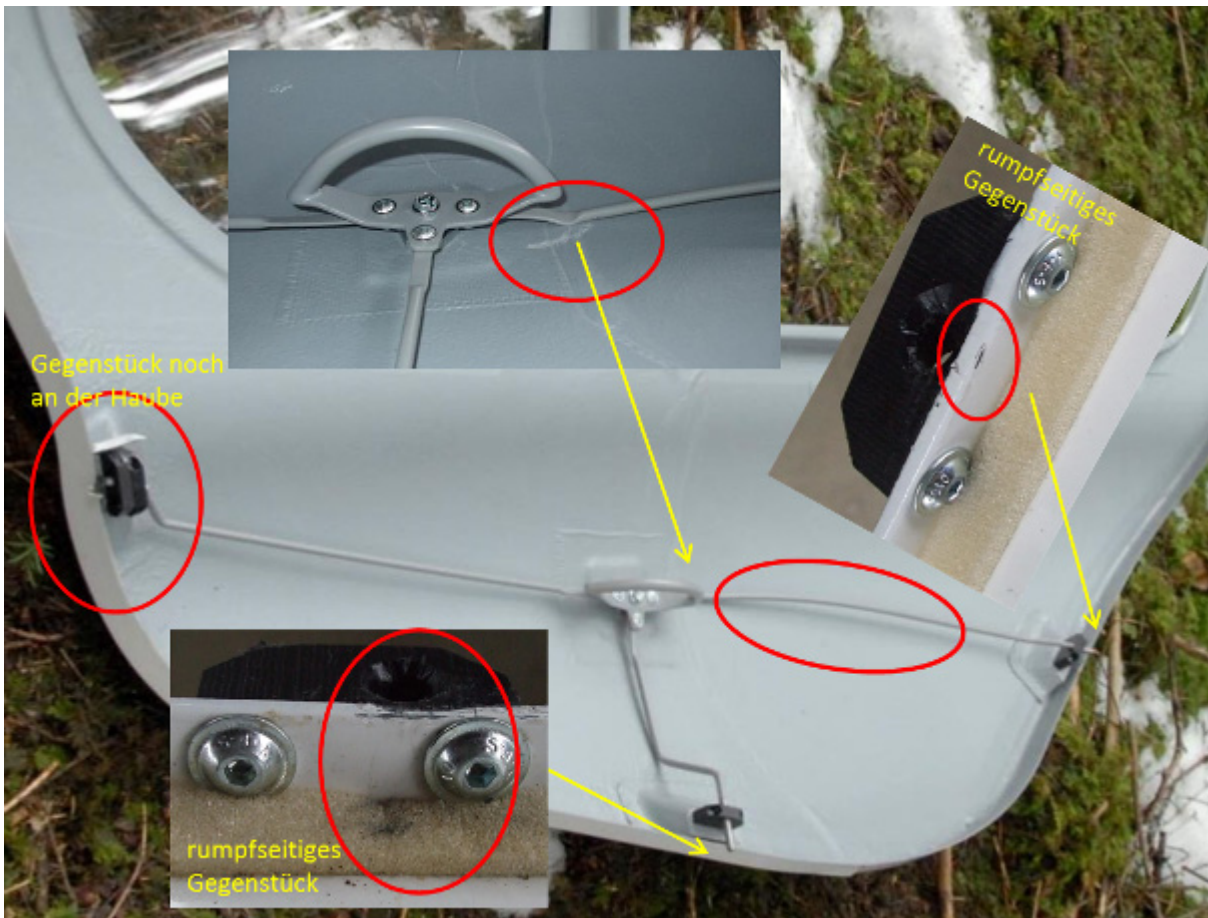
Zusammenfassung der Befunde zur Haubenverriegelung
