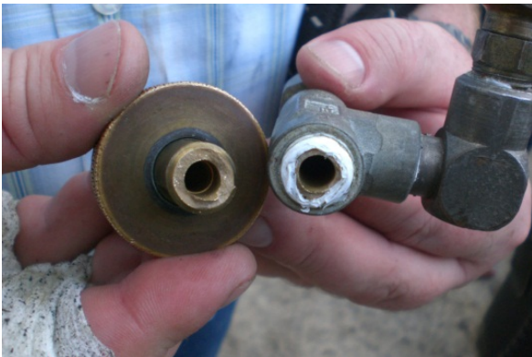
gebrochenes Anschlussstück der Ringleitung
