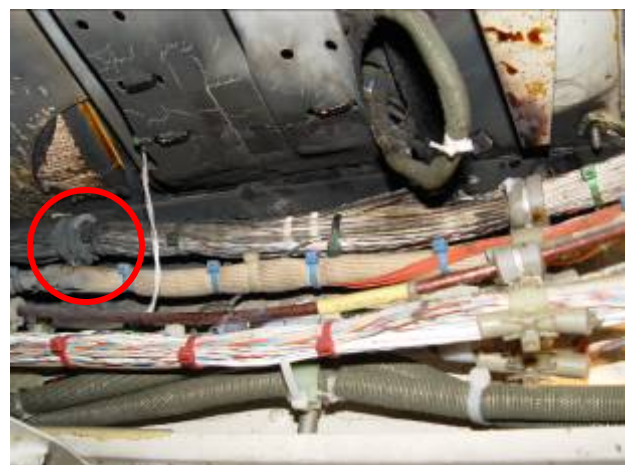
Foto oben: Schadenstelle im Kabelstrang
