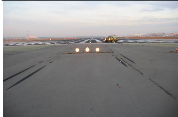
Aufsetzspuren sowie zwei fehlende Lampen rechts und links
