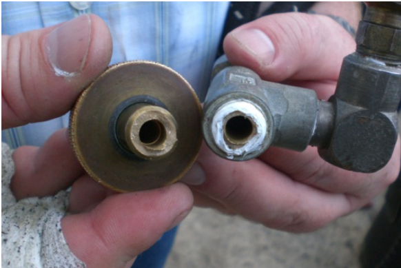
gebrochenes Anschlussstück der Ringleitung
