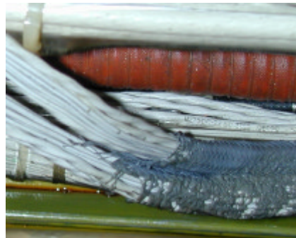
Position (A) Schadstelle am Kabelbaum, wie bei (B) gekennzeichnet durch eine versengte Ummantelung aus Polyamid-Gewebe aber kaum beeinträchtigte Kabelisolierungen aus PTFE und Kabelbinder aus Polyethylen
