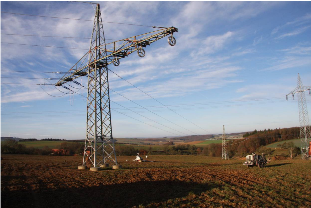
Übersicht letzter Stromleitungsmast, Anhänger und Unfallstelle
