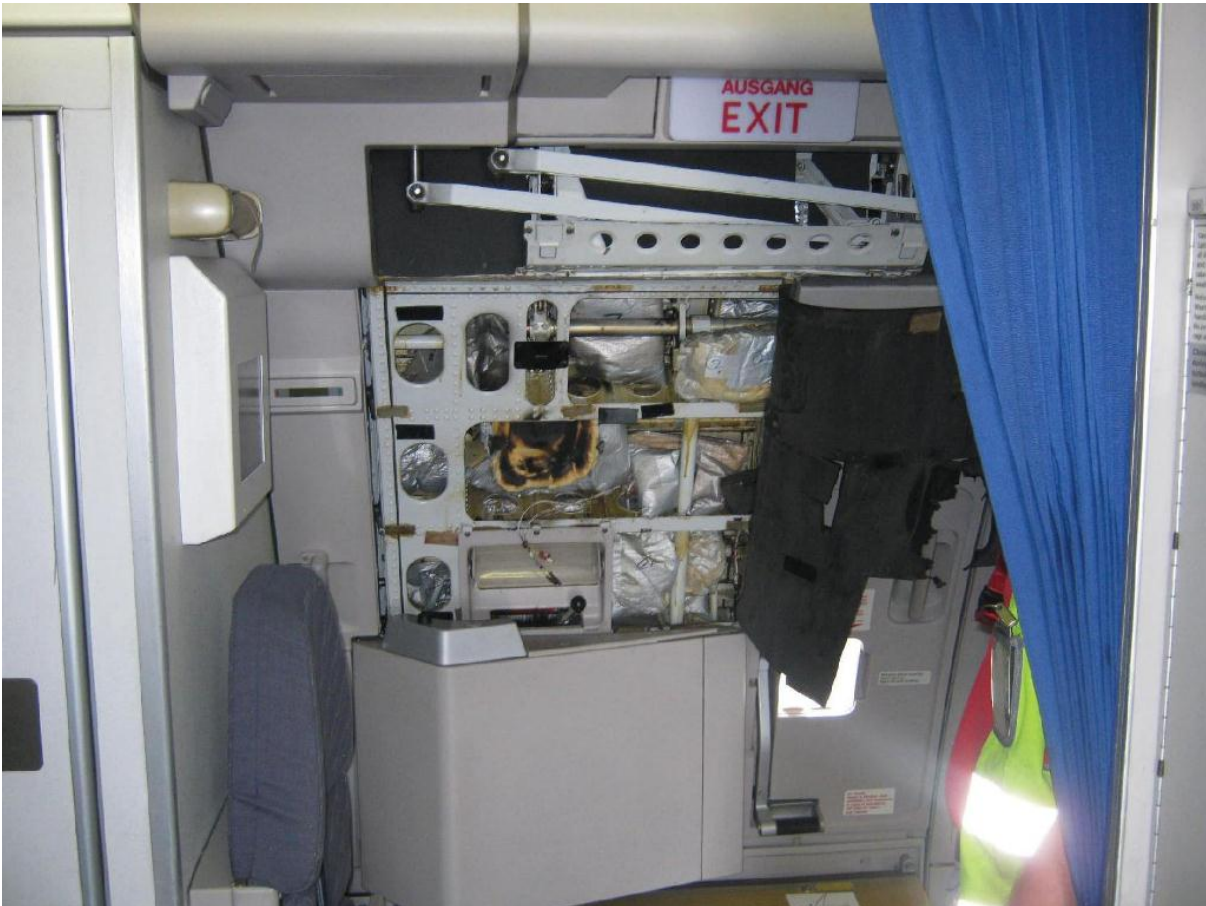
Brandstelle an der Tür 2R nach dem Entfernen der Verkleidung
