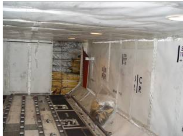
Brandstelle im Frachtraum
